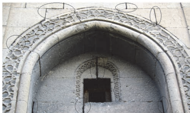
Slika 7. Lokalna oštećenja morta između kamenih elemenata
