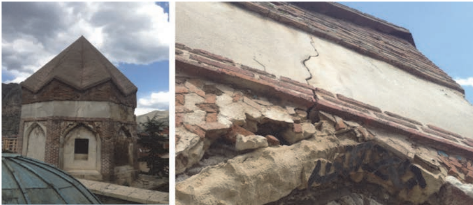
Slika 8. Duboke pukotine na osmerokutnoj piramidi
