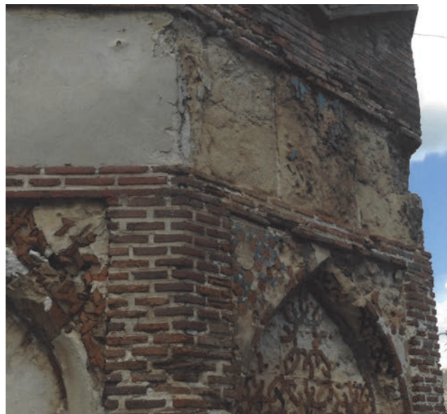
Slika 6. Propadanje materijala ugrađenog u konstrukciju
